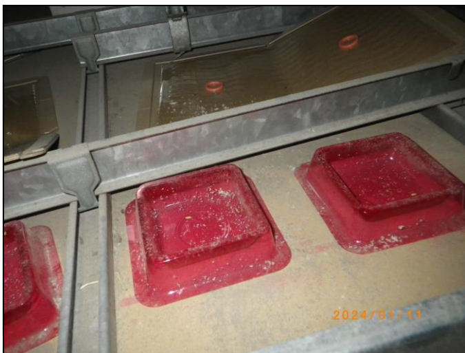
通路天井裏:殺鼠剤に喫食確認 11
