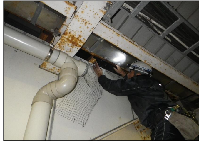
雨樋隙間: ネット取付 17
