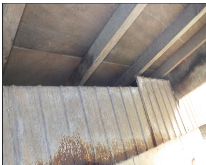
台所出窓下侵入場所：遮断処理前② 13
