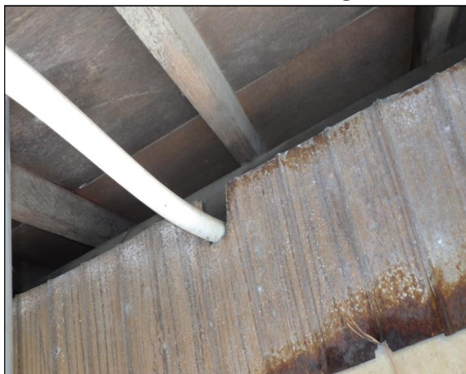
台所出窓下侵入場所：遮断処理前① 12
